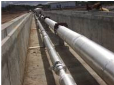
Canalisations LOX et LIN
